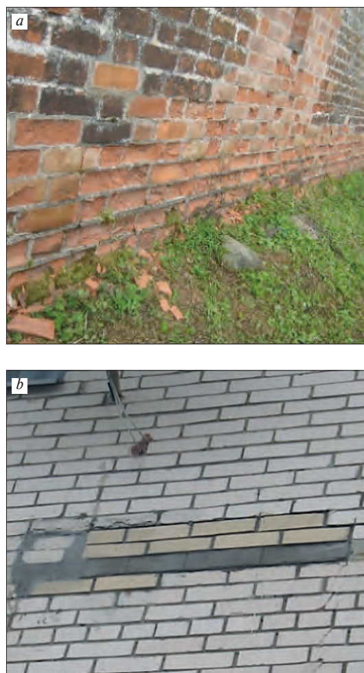
Рис. 6. Примеры повреждений восстановленной каменной кладки: a – деструкция лицевого слоя; b – трещины в области вычинки
